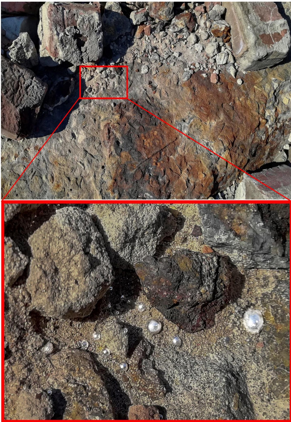
Рисунок 7. Поверхня балки перекриття (корпус 105 цеху електролізу).
