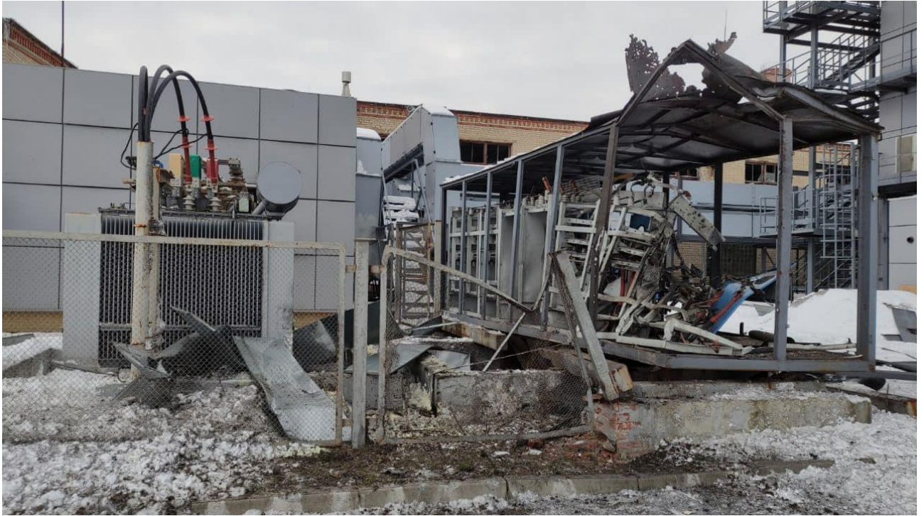
Фото 1. Зруйнована підстанція РУ-0,4кВ
