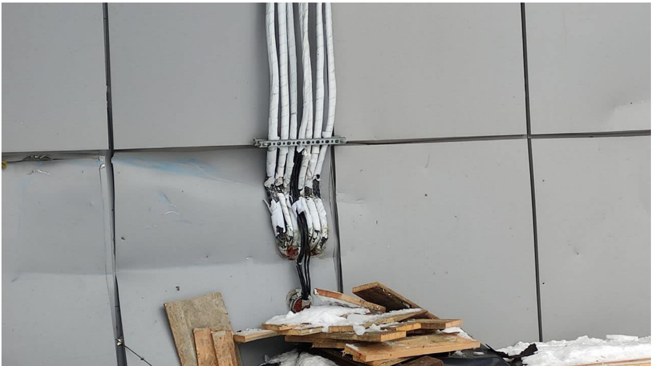
Фото 2. Пошкодження кабелів кондиціонерів системи охолодження кластерні галереї
