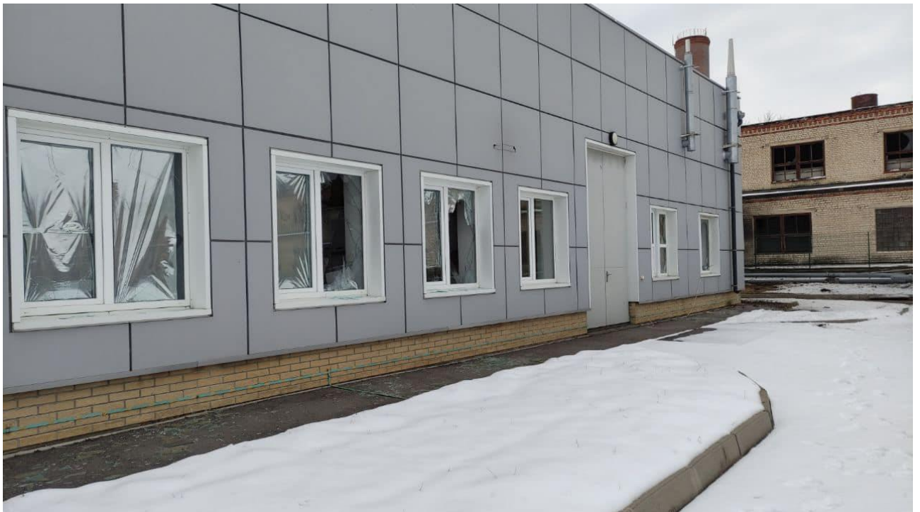
Фото 6. Пошкодження будівлі насосної та градинь лабораторії ізотопів
