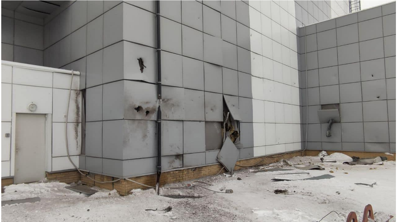
Фото 3. Пошкодження основної будівлі ЯПУ
