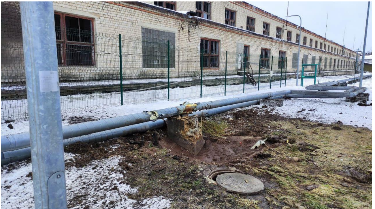
Фото 4. Пошкодження теплотраси до комплексу будівельна споруд ЯПУ
