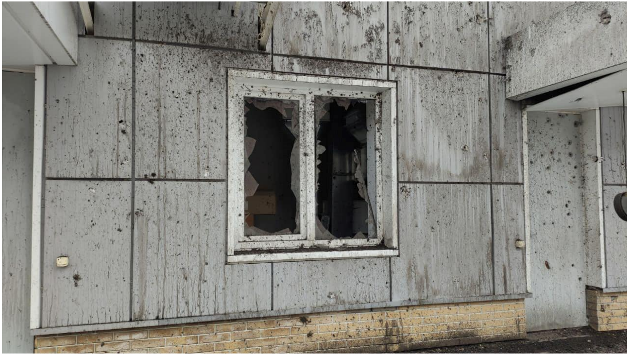
Фото 5. Пошкодження будівлі насосної та градинь лабораторії ізотопів
